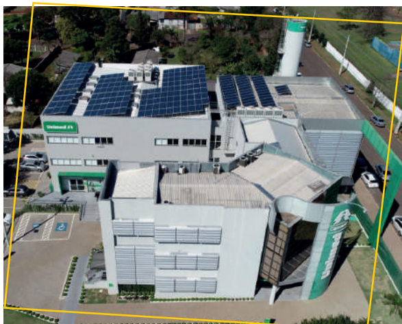
Placas solares fotovoltaicas instaladas na unidade sede
